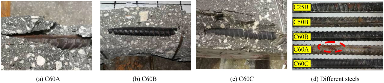
图 10 CA/CC 中不同种类钢筋的锈蚀状态(测试龄期 240 天)
