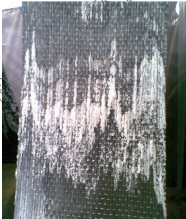
图 5 CFRP-混凝土试件 C30-25-15-180 CFRP 表面结晶体
